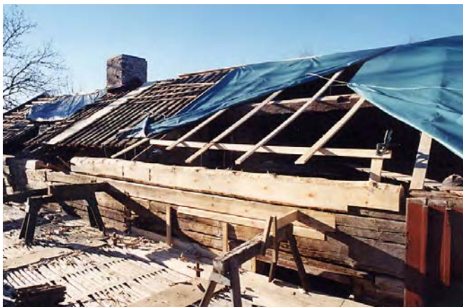
Samma parti av köksväggen (västra huset) - hela väggen upp till hammarbandet byttes. Okt. 2002.
