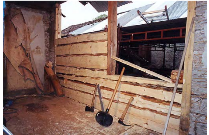
Östra väggen i köket hade varit gravt rötskadad och timret i större delen av väggen fick bytas. Okt 2002.
