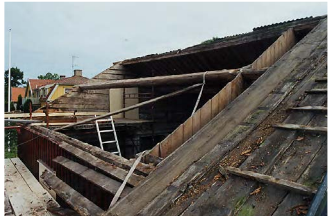
I stort sett hela taket var i så dåligt skick att det fick kasseras. Sep. 2002.
