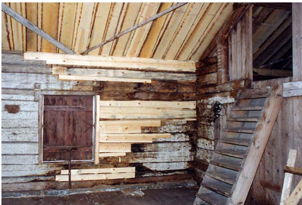
Väggen timrades upp på nytt med nytt timmer. Det nya taket sett underifrån. Nov. 2002.
